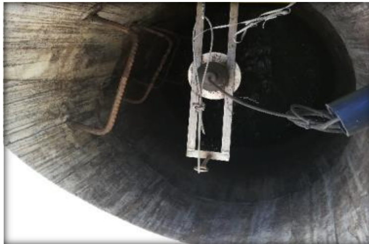
Figura 1.2 Sensor instalado por Etapa EP.
