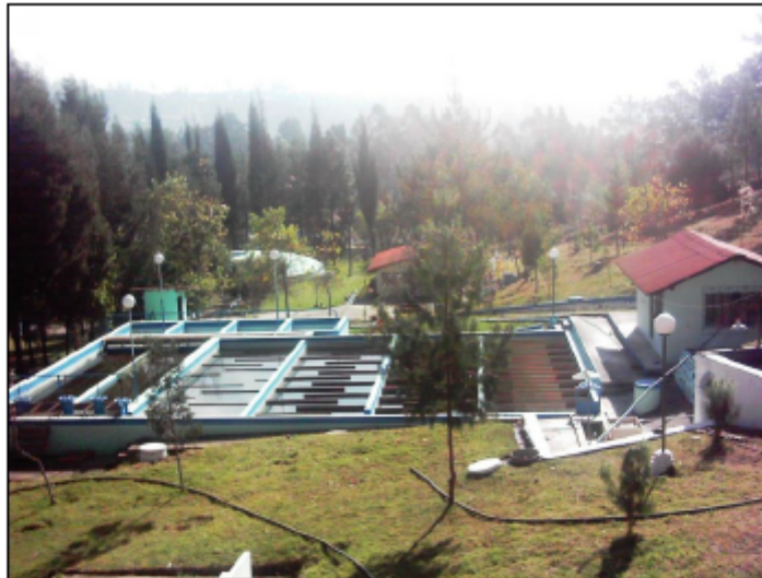
Panorámica de la planta de tratamiento (San Andrés).
