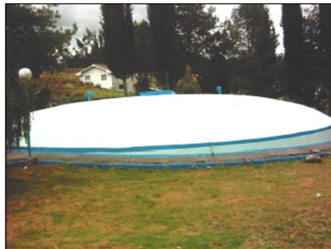
Tanque de distribución de 1000m 3 de capacidad.
