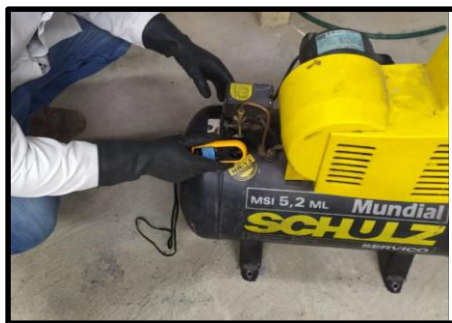
Ilustración 23. Medición de velocidad de flujo de aire.
