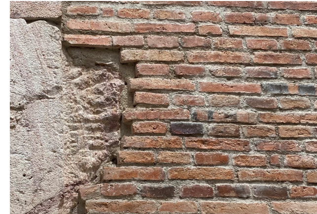
Figura 102: Deterioro en la fachada de la Catedral de la Inmaculada Concepción. Fuente: Elaboración propia.
