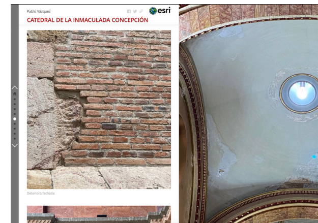
Figura 120: Visualización registro fotográfico de daños. Fuente: Arq. Andrea Calle.
