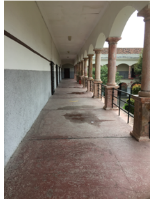
Estado actual de los pasillos
