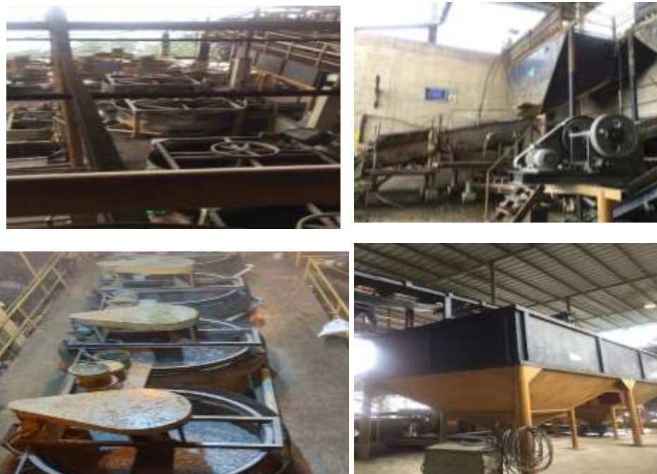
Figura 4.6 Evidencia riesgo físico en planta.
