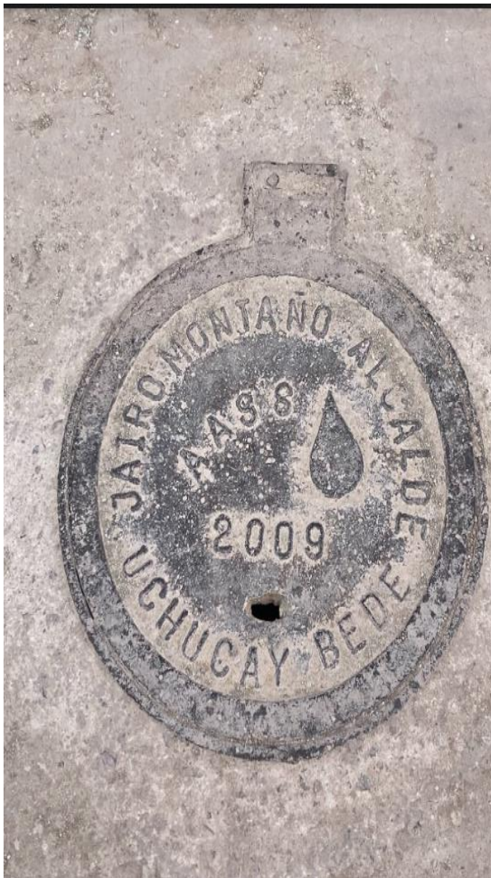
Figura 2.4: Tapa de pozo de revisión.
