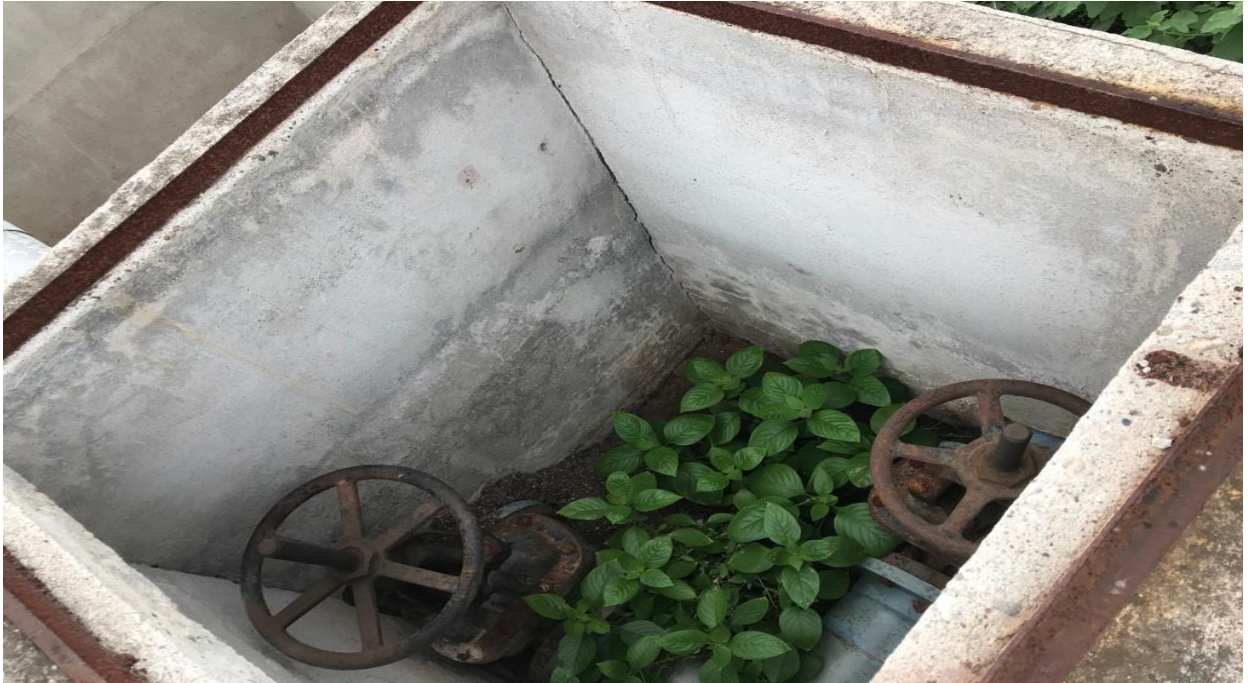
Figura 3.10: Estado de la caja de válvulas.
