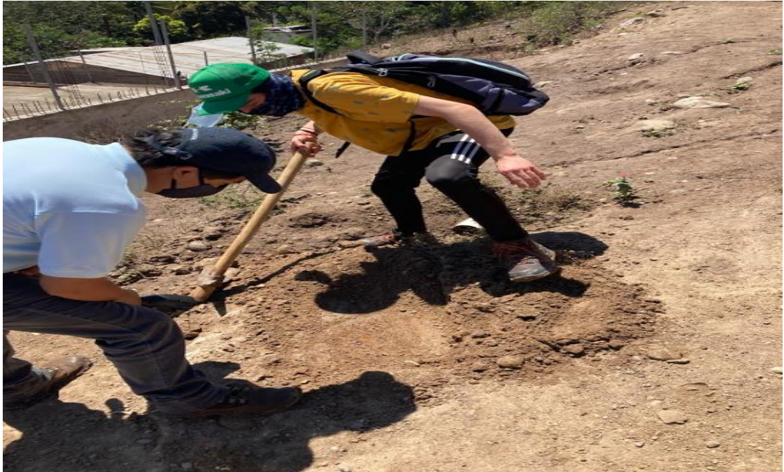
Figura 2.6: Pozo de revisión enterrado por completo.
