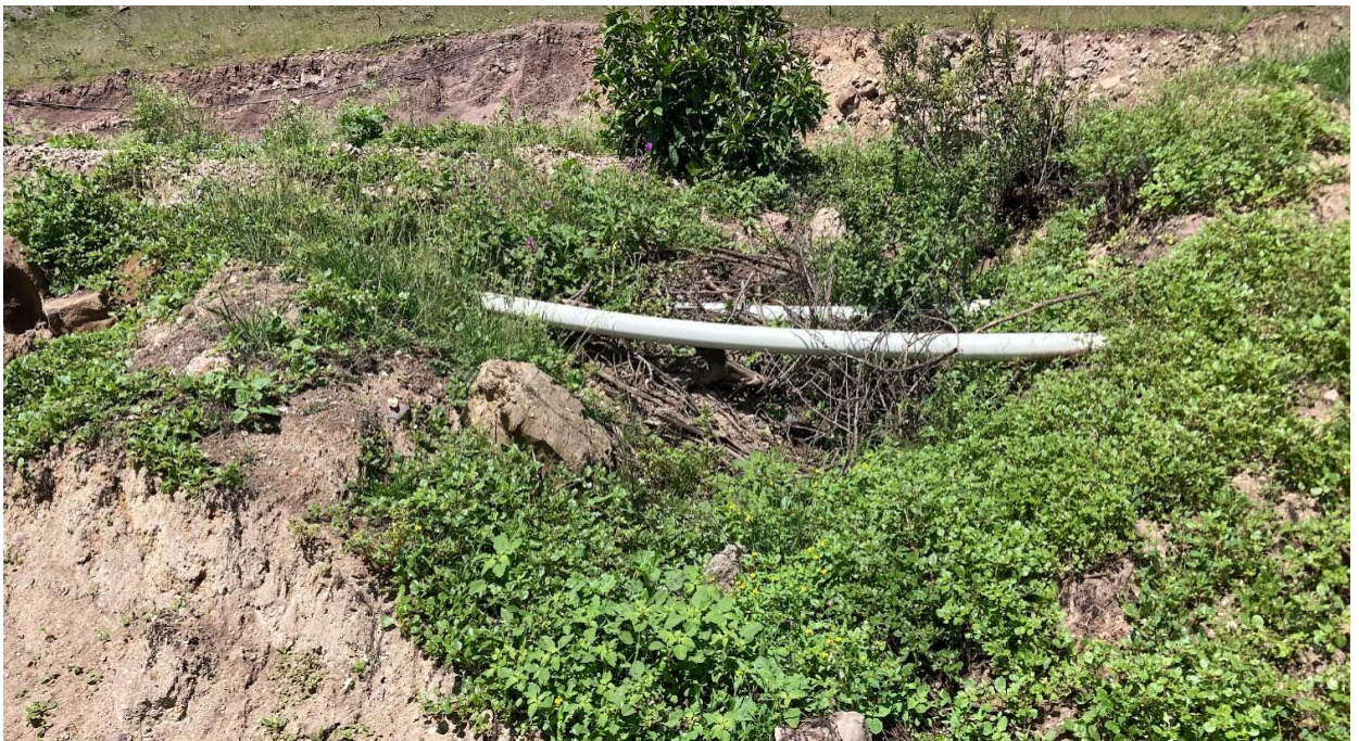
Figura 3.11: Estado de las tuberías de PVC usadas para la descarga del efluente al río Uchucay.
