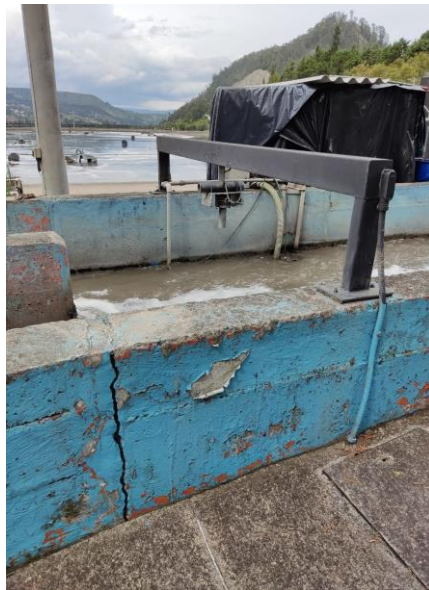
Figura 2. Viga de acero con el medidor ultrasónico de la planta de tratamiento de agua de Ucubamba.
