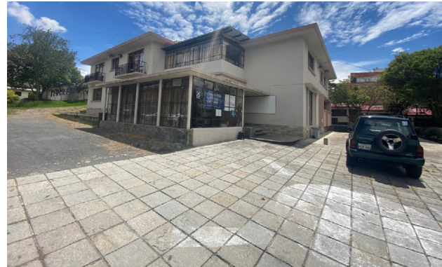
Infraestructura deteriorada y sin intervenciones ARCHIVO PERSONAL
