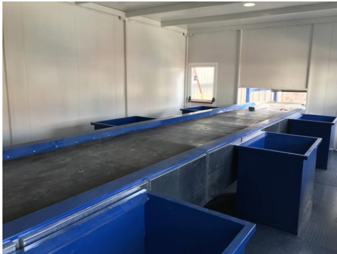
Figura 12 Banda transportadora de residuos con cajas de almacenamiento
