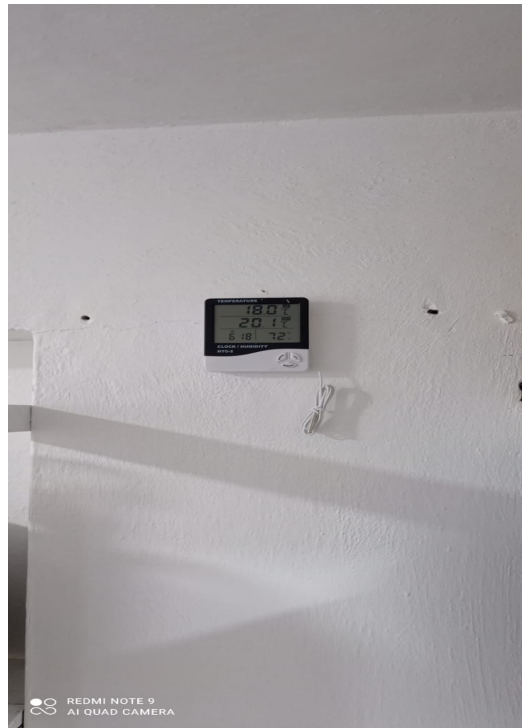
Figura 31. Implementación de controlador de temperatura en la fábrica Digu B&C
