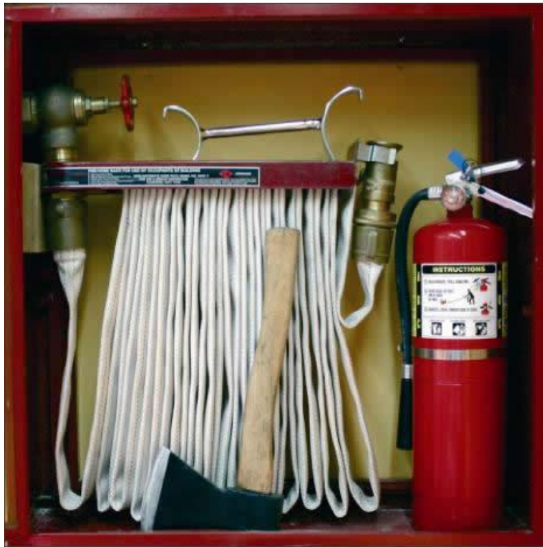
Ilustración 40: Gabinete Contra Incendios
