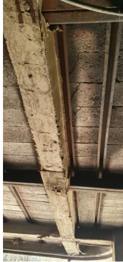
Figura 2.19. Segregación y desprendimiento del hormigón Fuente: Propia (2022)
