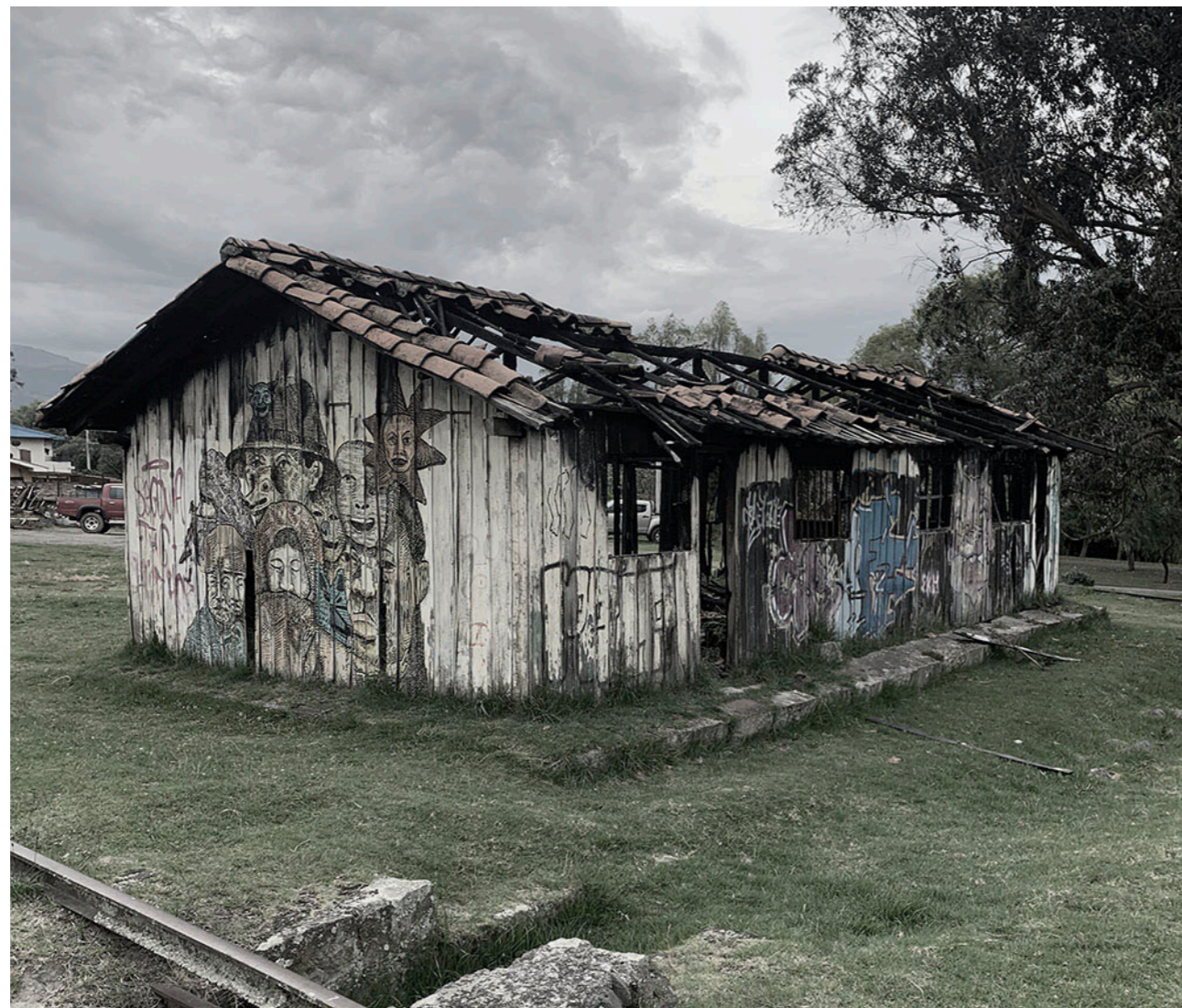
Figura 02. Bloque destruido por incendio.
