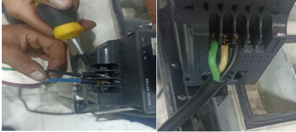
Figura 22 Conexiones en el variador
