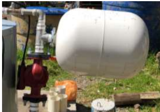
Figura 8. Bomba de recirculación conectada al tanque hidroneumático
