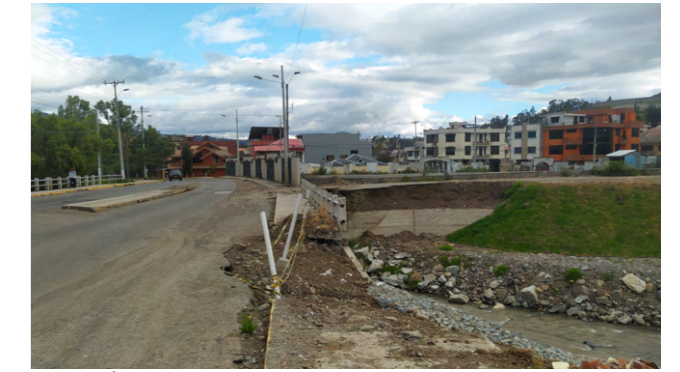
Foto 3. Vías en deterioro y en mal estado. Fuente: Autor.
