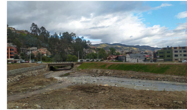
Foto 1. Márgenes del Río Burgay afectadas. Fuente: Autor.
