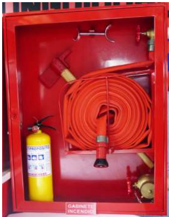
Gabinete contra incendio
