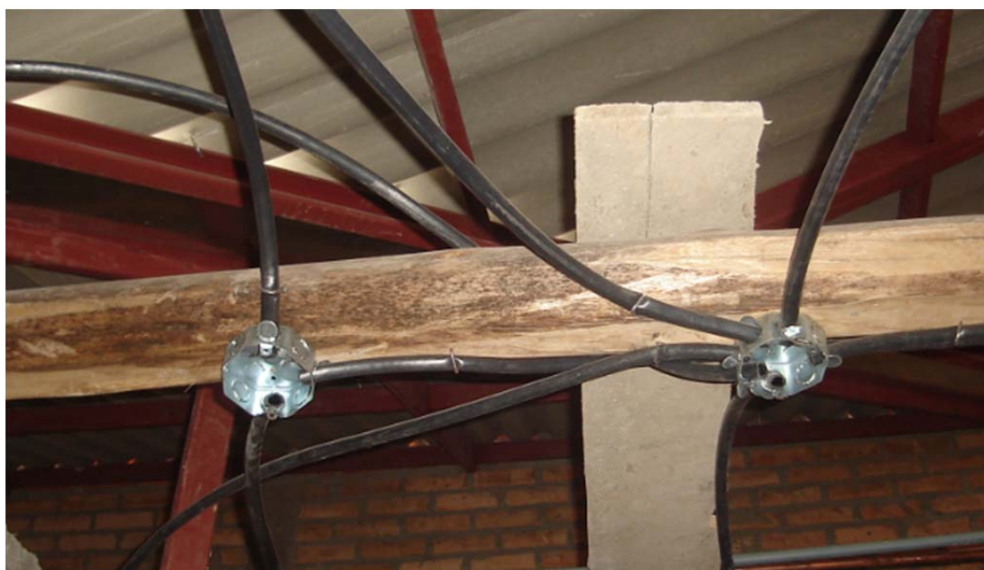
Figura A20: Cableado eléctrico en la planta baja
