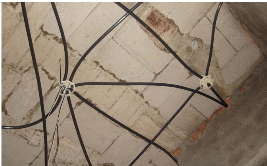
Figura A19: Cableado eléctrico en la planta baja
