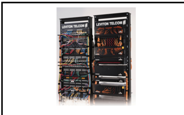
Figura 1.8 Closet de telecomunicaciones
