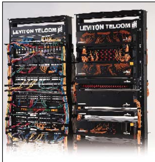
Grafico 42. Ejemplo 2 de Rack de Telecomunicaciones
