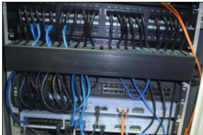
Grafico 64. Rack en el Edificio de Administración Central
