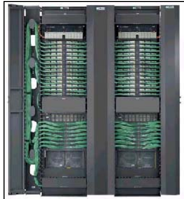
Grafico 41. Ejemplo 1 de Rack en Cuartos de Telecomunicaciones
