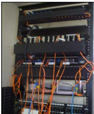
Grafico 58. Rack Principal en el Centro de Computo
