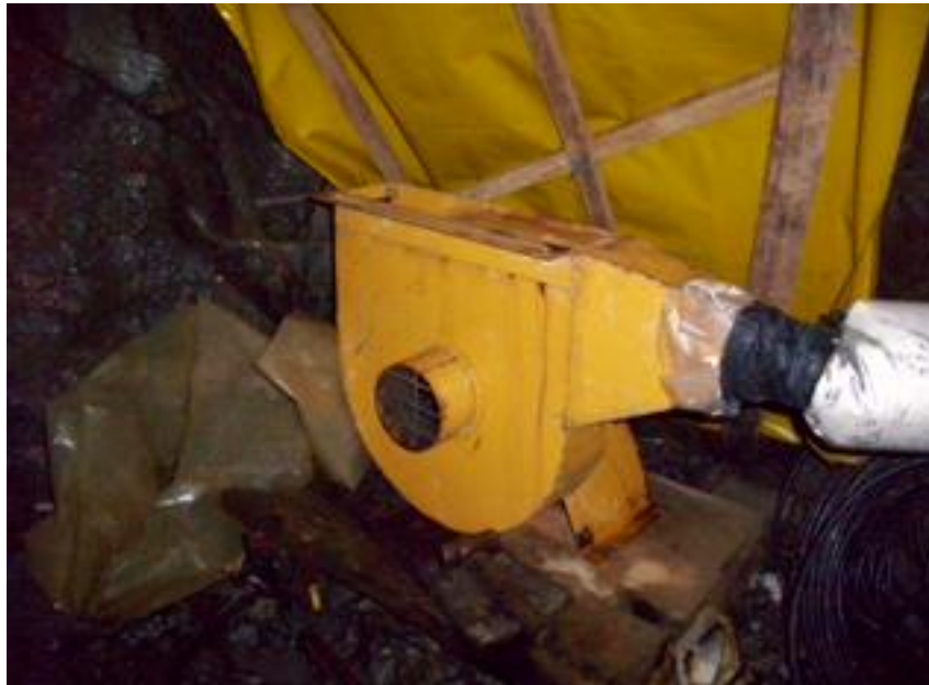
Foto N.- 15 ventilador para extraer el gas de la mina.
