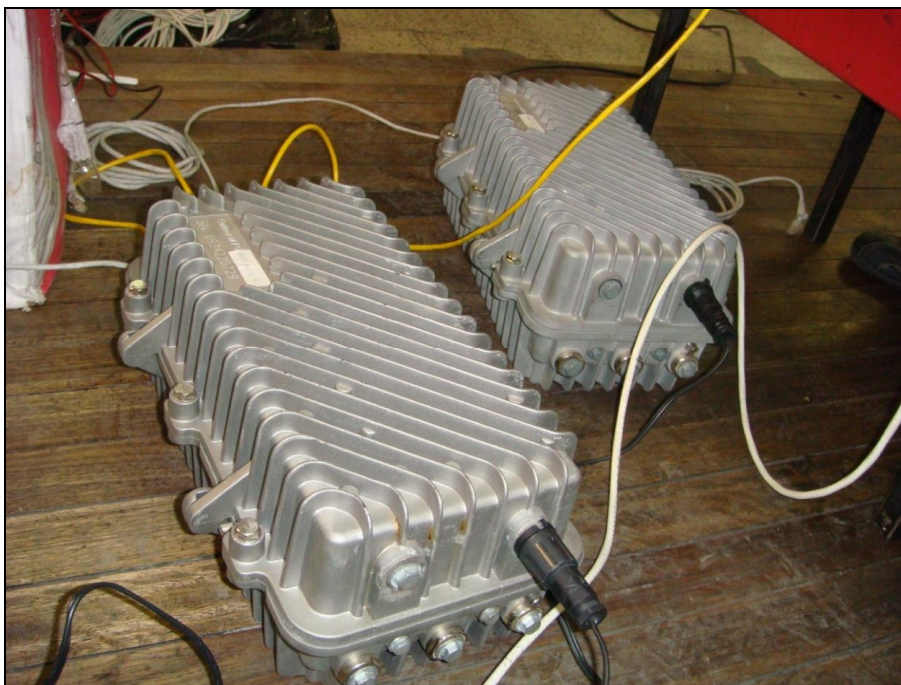
Fotografía 3.1: Instalación típica de un Repetidor
