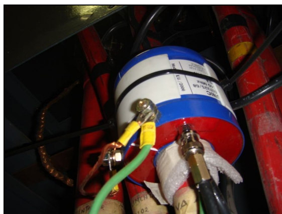
Fotografía 3.2: Instalación típica de acoplador inductivo en una fase
