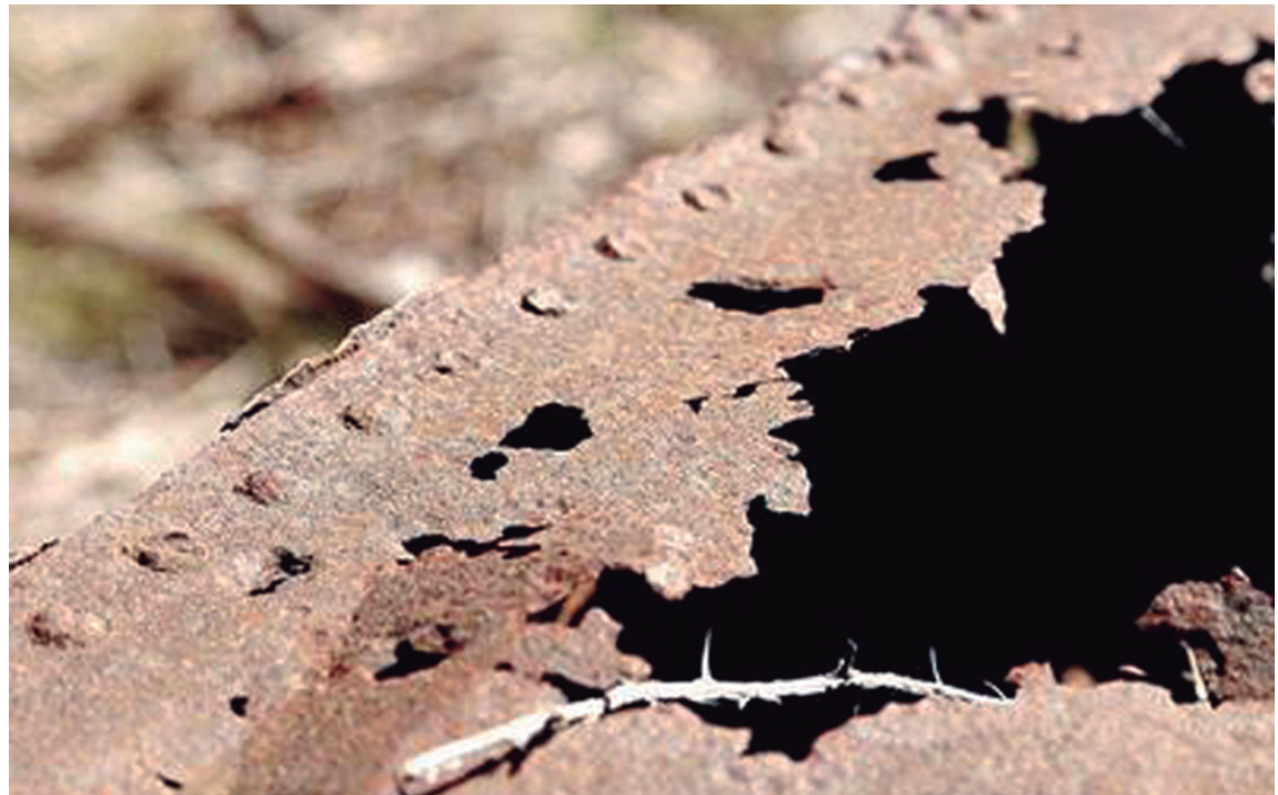
F 16. Metal corroído
