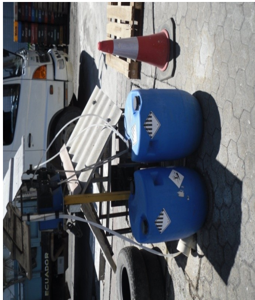
FOTO 02: Planta de tratamiento de aguas residuales de la empresa.
