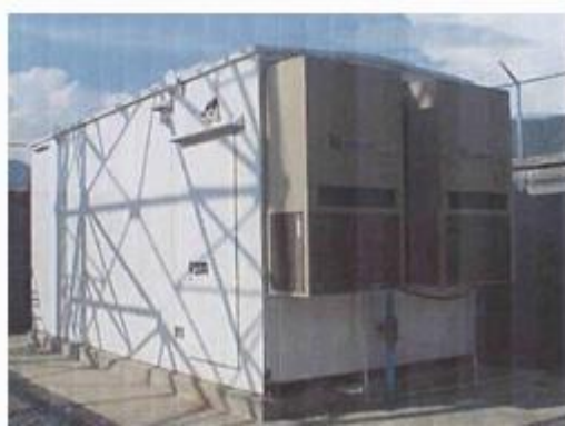
Figura 17. Contenedor para equipo de telecomunicaciones (Forcada, 2008)
