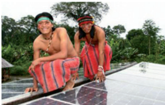
Sistema fotovoltaico en Sharamentsa, provincia de Pastaza. Genera energía para el bombeo de agua ara los sembríos y consumo de luz.
