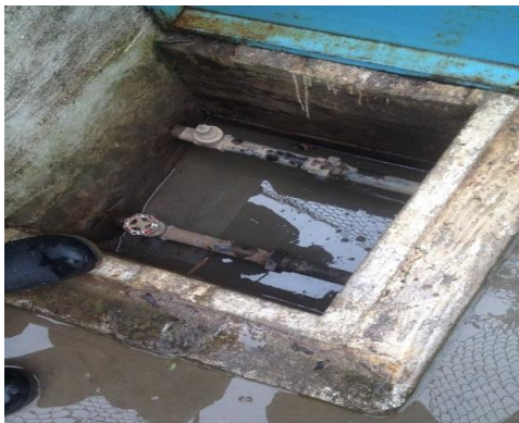
Fotografía 2. Caja de válvulas para limpieza existente de la captación
