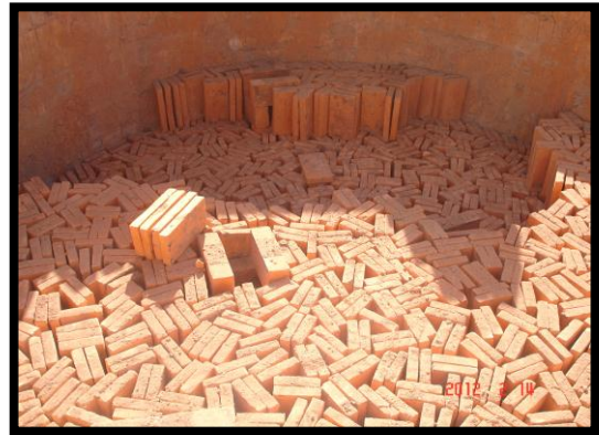
Foto10. Aplicación de chimeneas diseñadas por EELA
