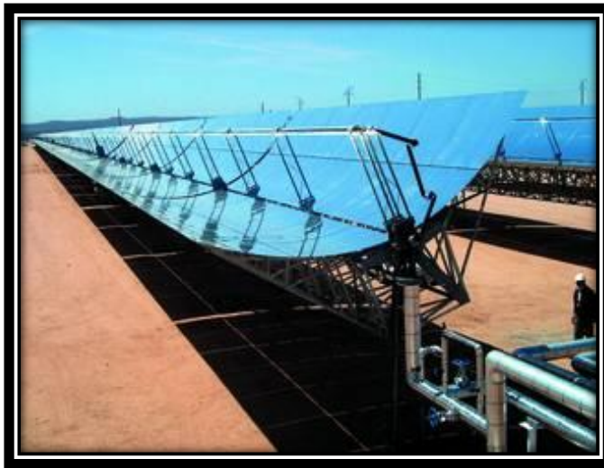
Figura 1.2: Concentradores Cilindro Parabólicos
