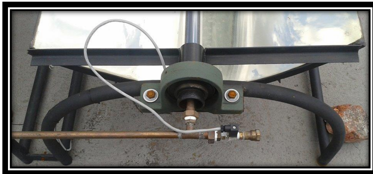
Figura 3.7: Ubicación del sensor de caudal
