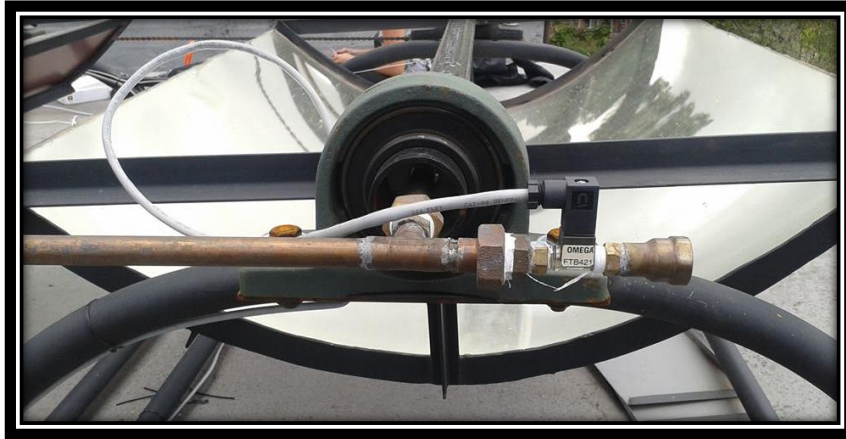
Figura 3.6: Ubicación del sensor de caudal
