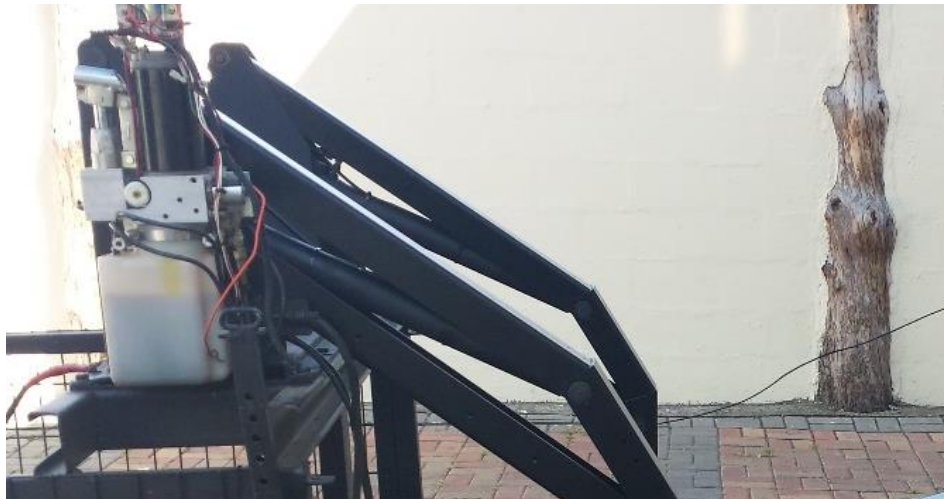
Figura 3.36. Ubicación de la unidad hidráulica
