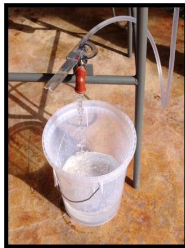
Figura 34: Regulación de apertura de la válvula
