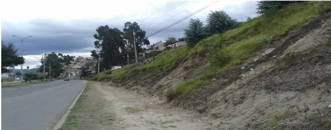
Figura 2.2. Talud inestable sector de Quinta Chica.
