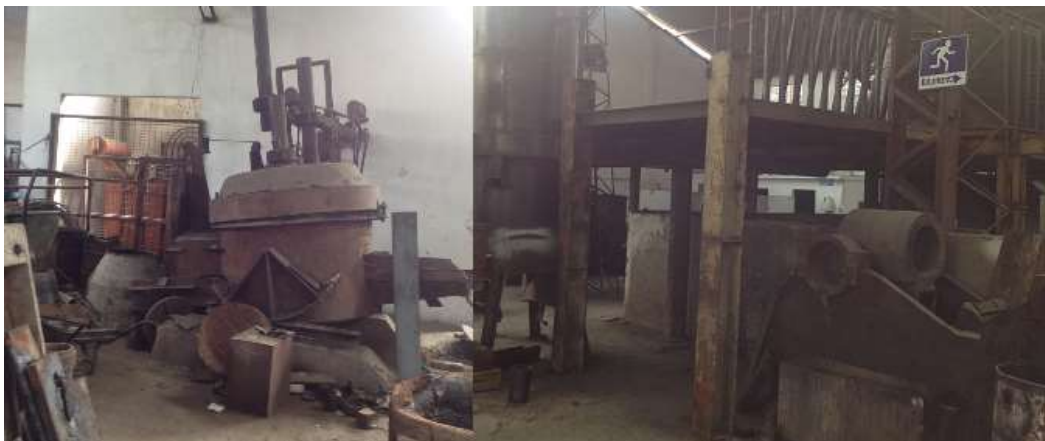
Figura 3.2: “Horno Eléctrico de electrodos y Cubilote de talleres Mejía”
