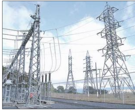
Figura 2. 5 Torres de retención y remate.
