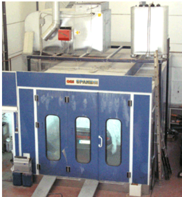
Figura 2.15 Vista del grupo impulsor y grupo extractor de un horno SPANESI
