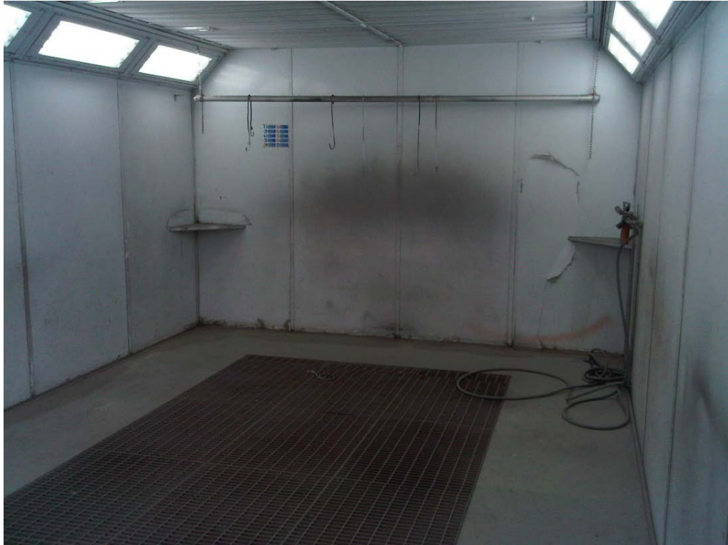
Figura 2.18 Cabina, filtros de entrada en el techo y de salida en el piso.
