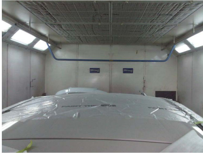
Figura 2.21 Iluminación dentro de la cámara de secado.
