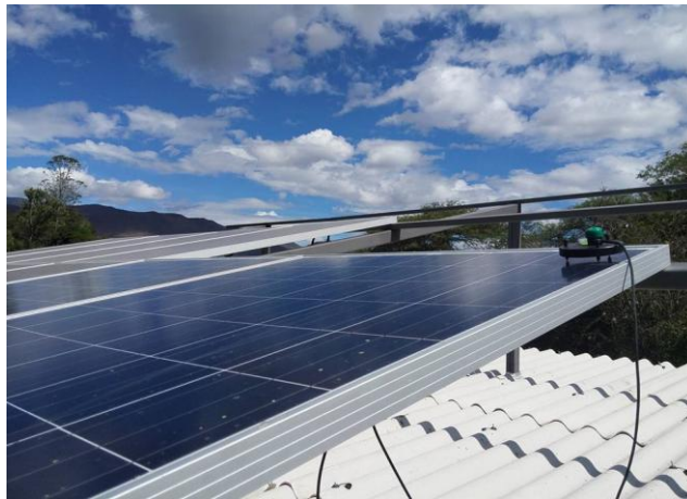
Figura 6.2 Panel solar y pirómetro utilizados en la prueba de bombeo Fuente: (Autoría Propia)
