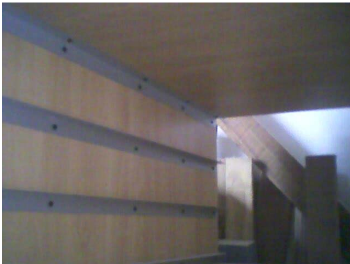
Vista interior de las uniones de las rieles
