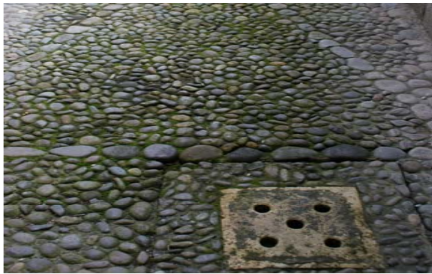
Sumidero y musgo verdoso producto de la humedad.
