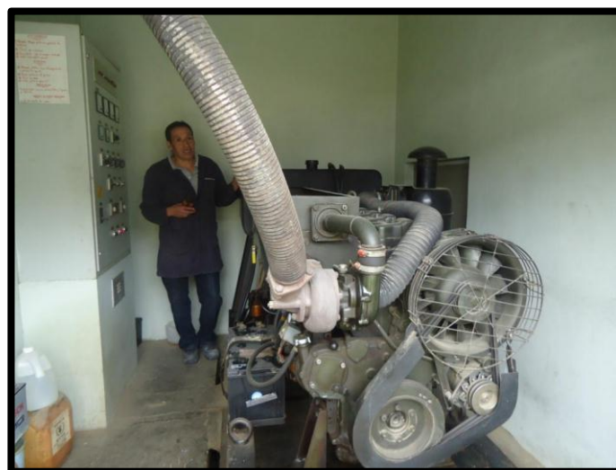
Figura 2.22: Generador eléctrico de emergencia
