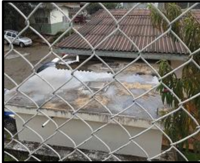
Figura 2.24: Acumulación de agua lluvia sobre la losa de cubierta
