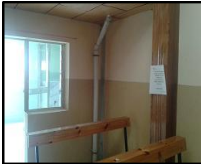
Figura 2.26: Bajante de agua lluvia al interior de capilla
