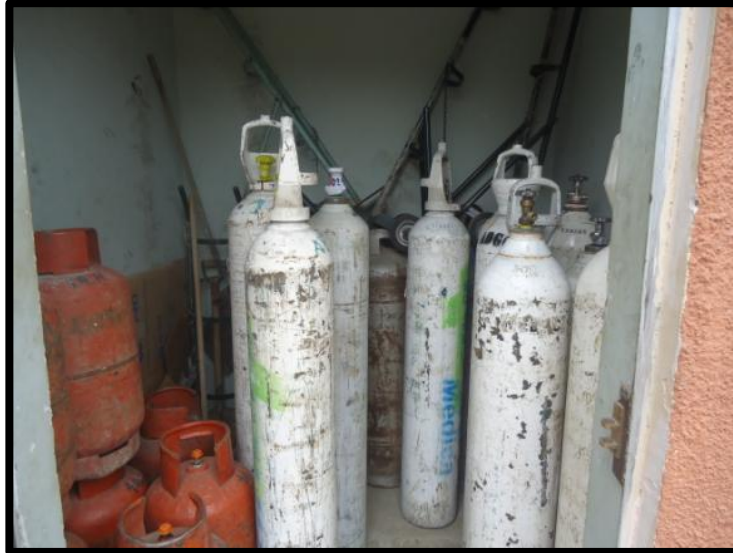
Figura 2.28: Área de almacenaje de gases
