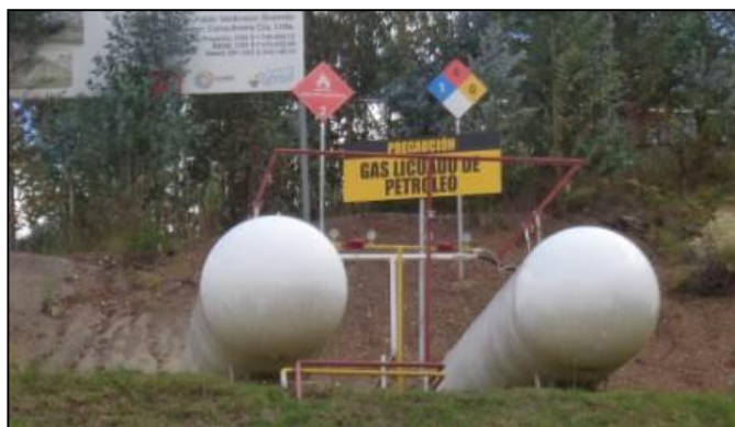
Figura 7. Bombonas de almacenamiento de GLP.
