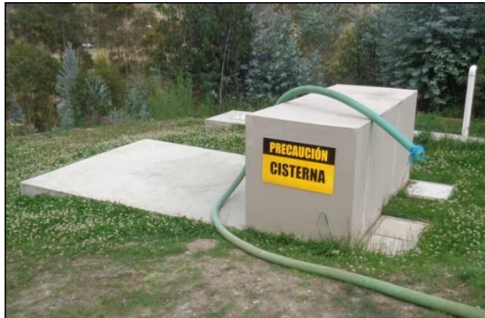
Figura 8. Cisterna Baja para almacenamiento de Agua.
