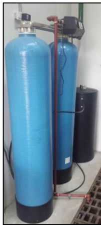
Figura 10. Tanque de Ablandamiento de agua dura.
