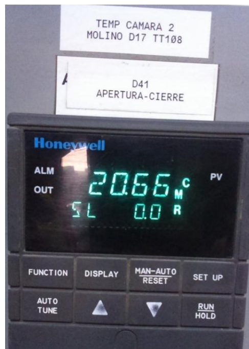
Figura 3.1 -Control regulable del dámper d41 Fuente: Autores – Panel Central Planta Industrial Guapán Azogues
