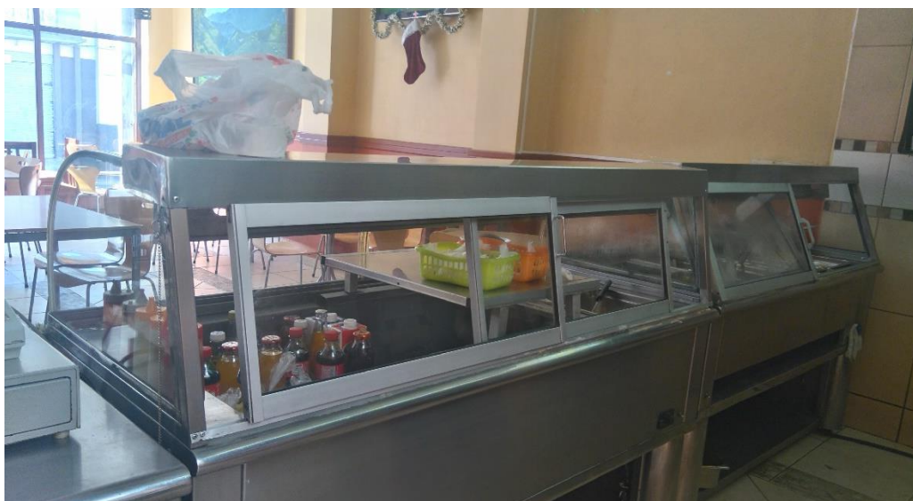
Fotografía 4 Área de Atención al Cliente y Cocinas a baño maría
