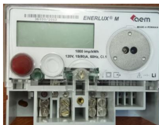
Figura 3.10: Medidor electrónico Enerlux.
