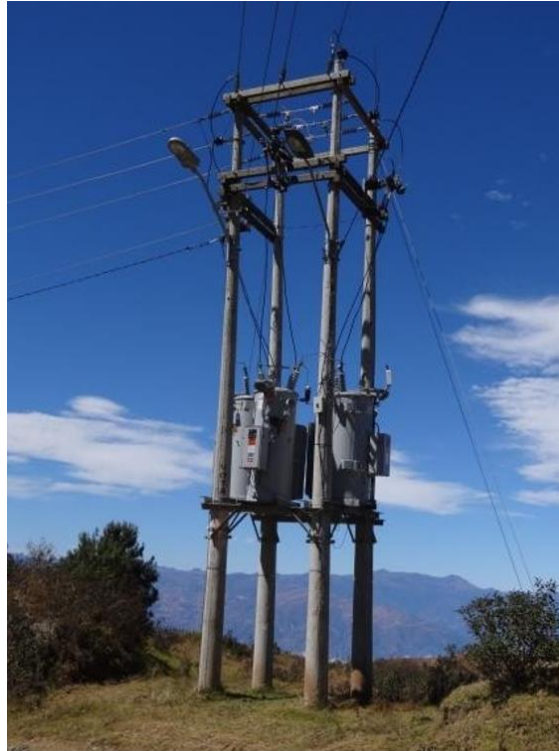
Figura 1.18. Transformadores de energía de la zona alta del cantón
