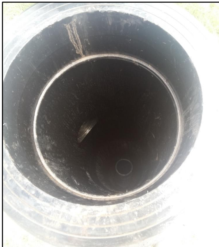
Figura 0.24. Pozo de biogás sin la tapa.
