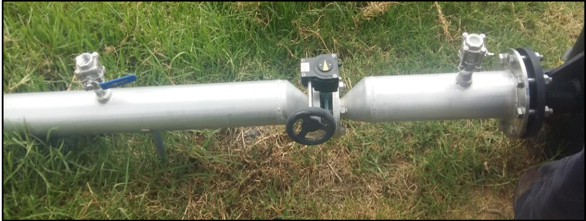
Figura 0.30. Tubería de acero inoxidable con los controles de presión.
