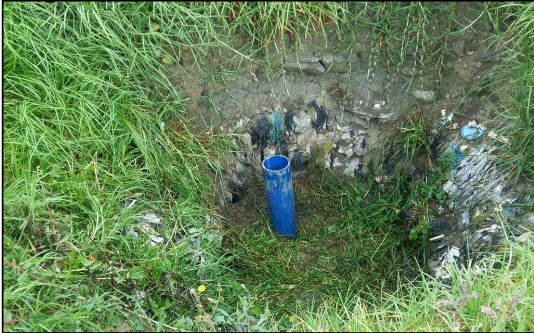
Figura 0.3. Estado en el que se encontraba el pozo de 160 milímetros.
