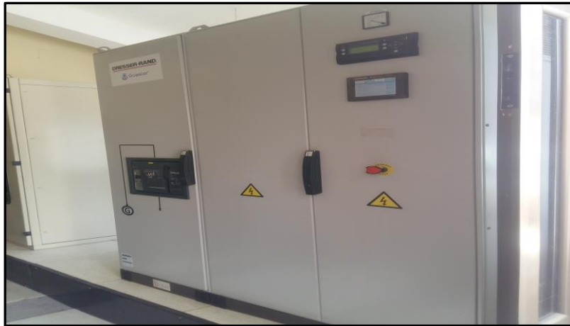
Figura 0.37. Paneles de control.
