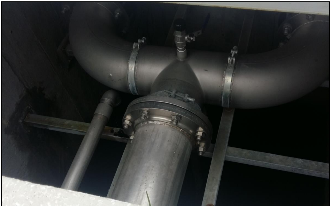
Figura 0.31. Líneas de biogás del norte I Y II.
