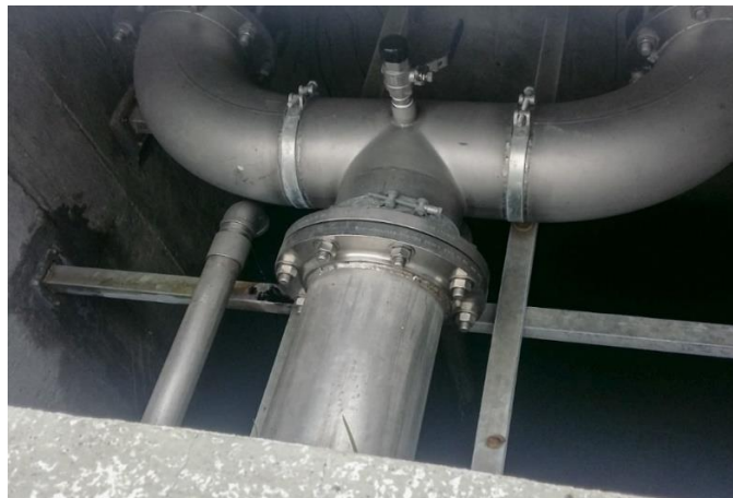
Figura 1.11. Condensador de gas.
