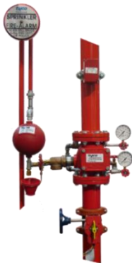
Imagen 4. Estación de control de flujo y alarma para una red de rociadores contra incendio.
