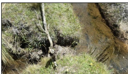
Figura 3.2. Foto filtración canal principal
