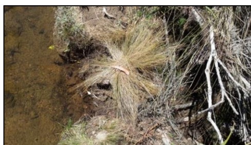
Figura 3.3. Foto Filtración canal principal
