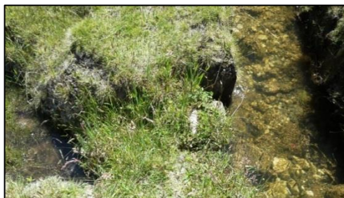
Figura 3.4. Foto filtración canal principal
