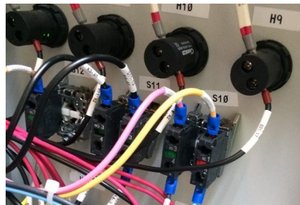
Figura 2.15 (b): Tablero de control PCG21 internamente.
