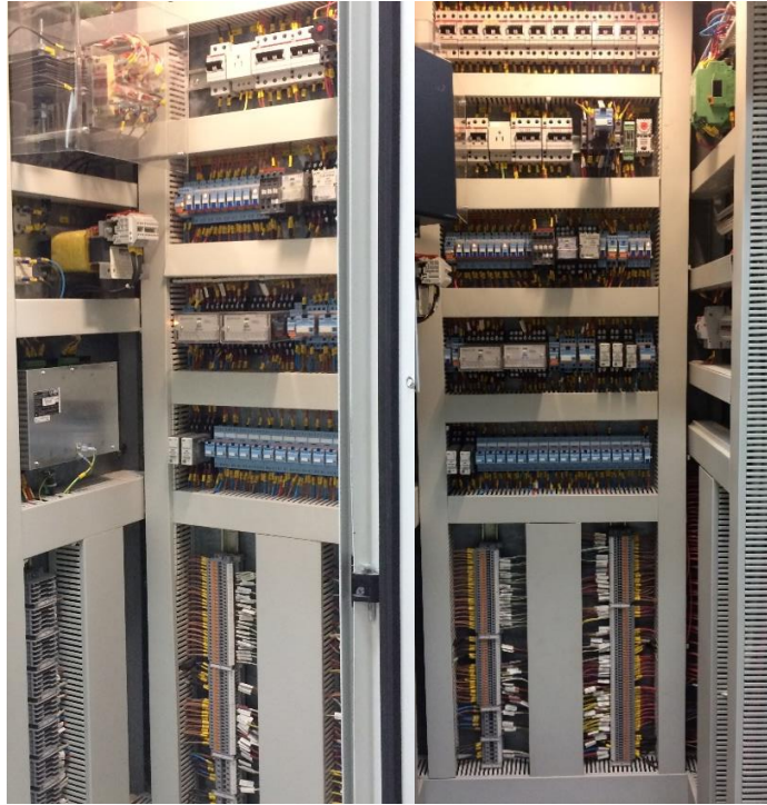
Figura 2.5: Visión general de la parte interna del tablero de excitación.
