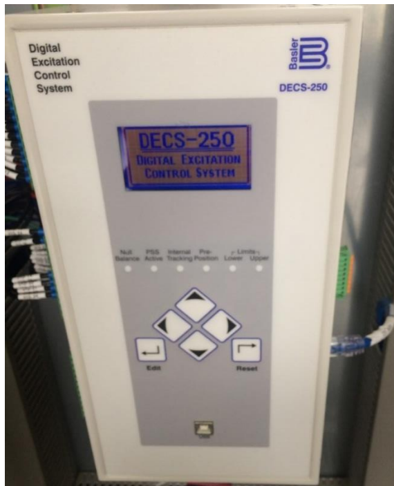
Figura 1.27: Sistema de Control Digital de Excitación DECS-250.
