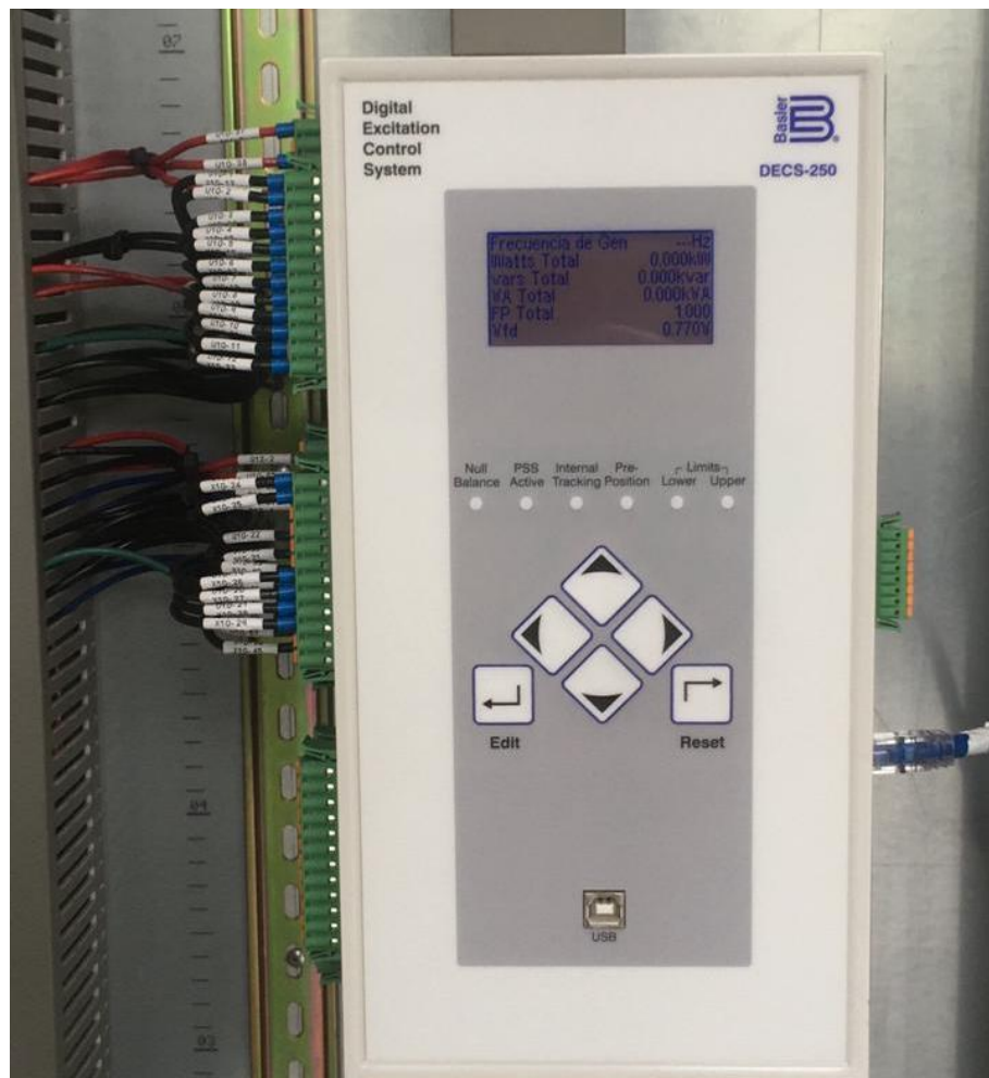
Figura 2.13: Tablero en el que se encuentra el DECS-250.
