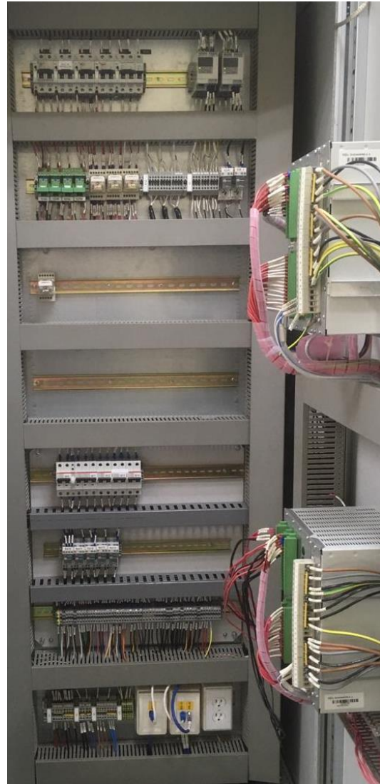
Figura 2.14 (b): Tablero PCG22 internamente.
