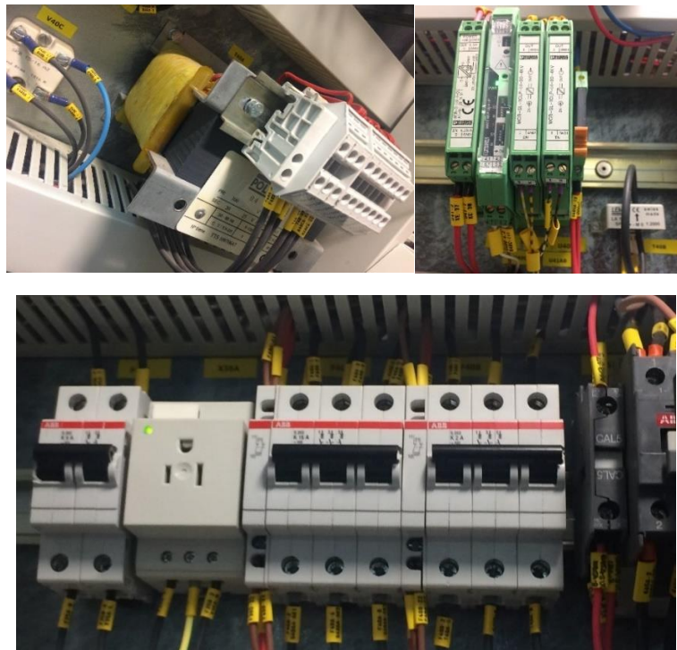
Figura 2.6: Componentes varios de los tableros de excitación.
