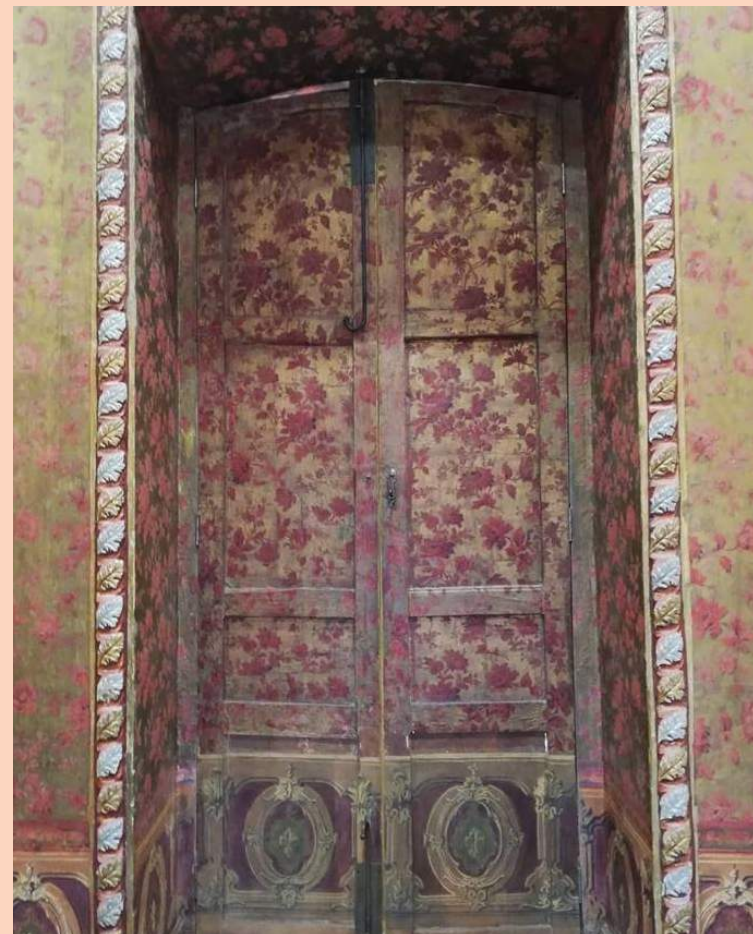
Figura 105: Puerta revestida de tela pintada.
