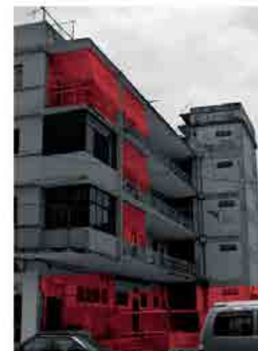
Fig 13. Multifamiliar, vista de errores.
